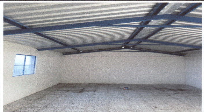
Foto 4 Cocina sustitucion de techo, lamina y repello de paredes, ventana y piso.
