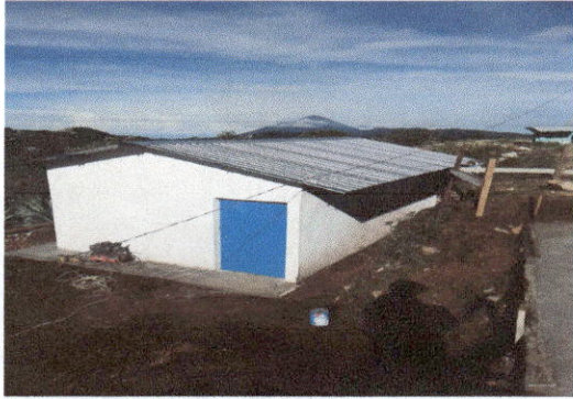
Foto 1. cocina sustitucion de techo, lamina, puerta repello de pared.
